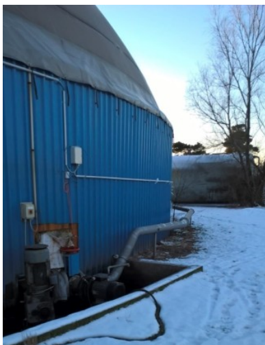
Billede 6. Pumpeanlæg (Foto: N. Østergaard).
